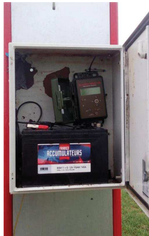
Figure 213 : SM4BAT et sa batterie installés dans un caisson de protection en bas du mât de mesure (G. Marchais, Écosphère)
